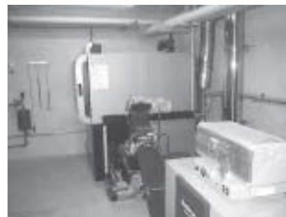
Chaudière à bois
